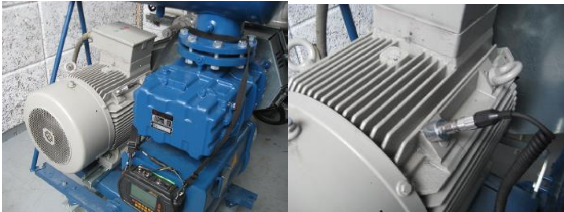
Figuur 19.1: Trilling meting aan gascompressor. Figuur 19.2: Plaatsing trilling opnemer op e-motor.
