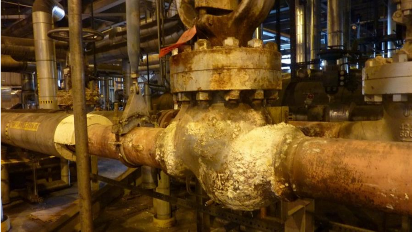
COI is een fenomeen waarbij zich corrosie vormt aan een asset onder de isolatie
