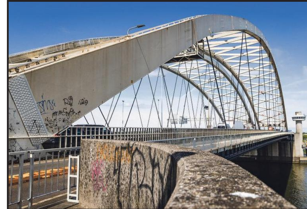
Roestplekken op de Van Brienenoordbrug. Dagelijks rijden zo'n 250.000 voertuigen over deze brug, die daarmee de drukste brug van Nederland is.
